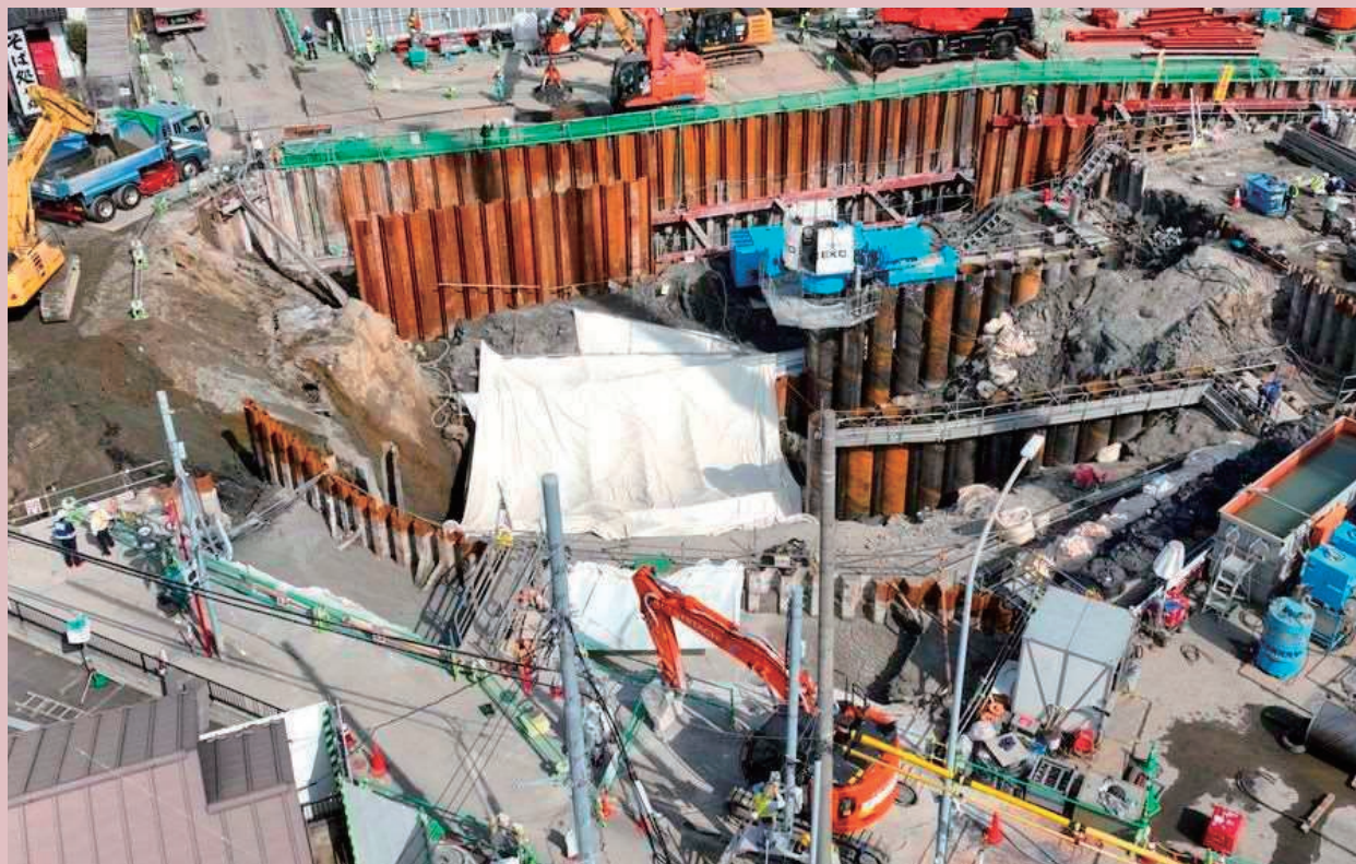
八潮市の道路陥没事故の復旧現場全景3月25日撮影(埼玉県提供)
