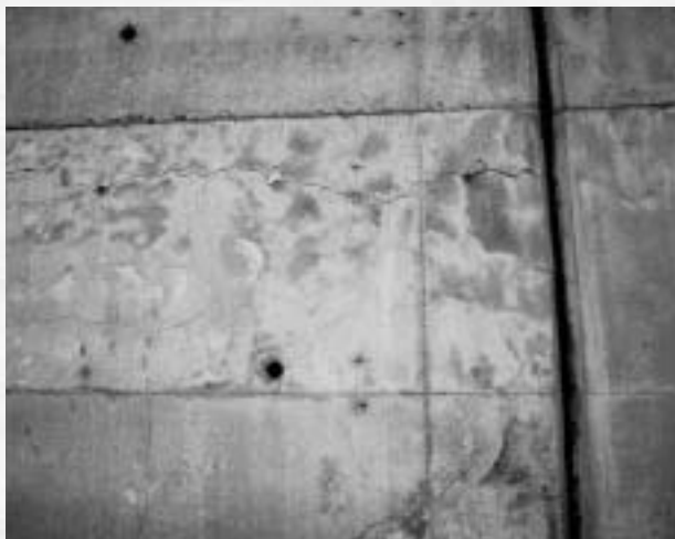
写真2 アルカリ骨材反応によるひび割れ
