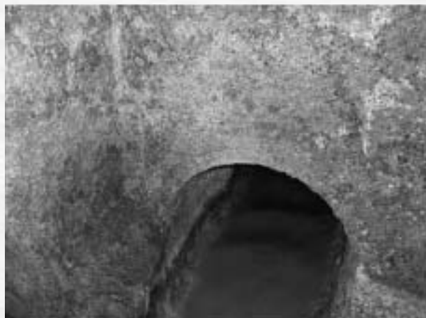
写真3 化学的腐食による劣化
