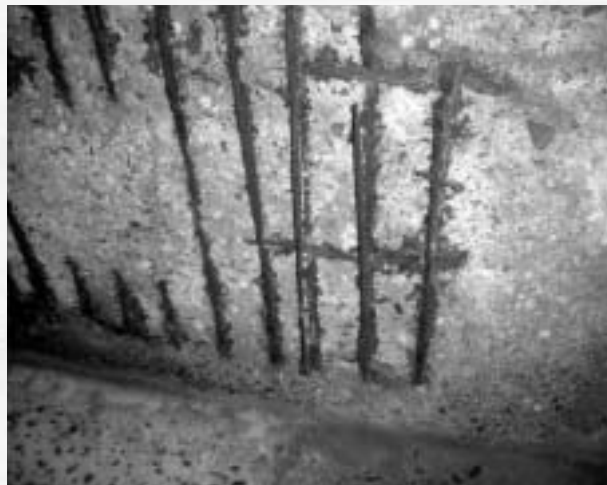
写真1 塩害による鉄筋腐食
