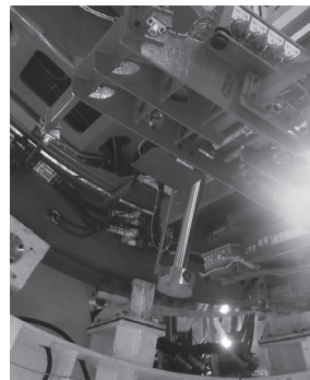
Bセグメント押上ジャッキ
