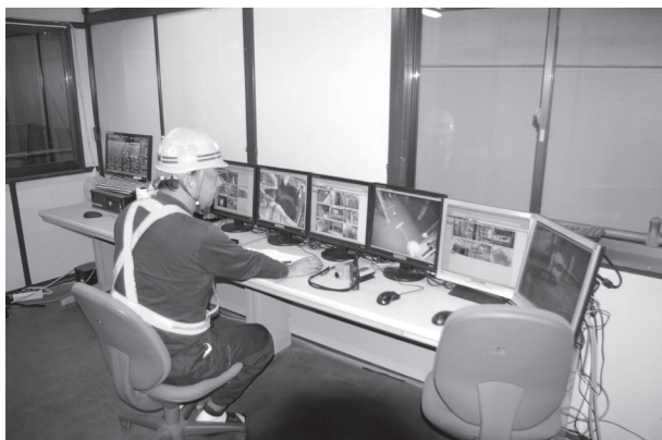
写真6 ●集中管理室全景
