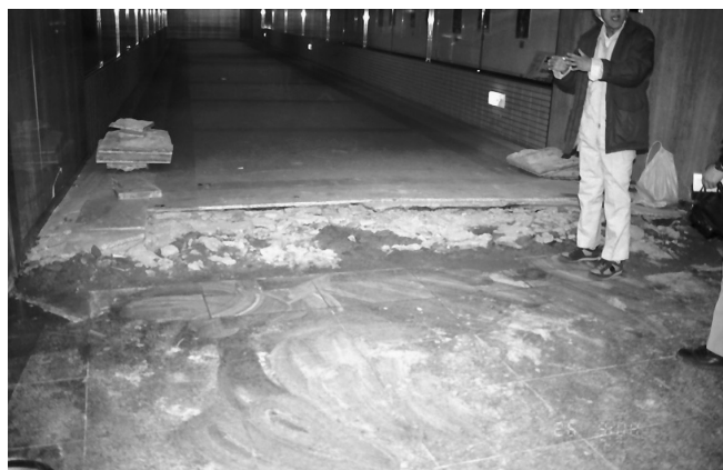
写真6 ジョイント間に生じた相対変位によって生じた地下街の損傷(1995年兵庫県南部地震)
