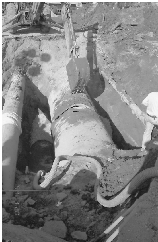
写真1 引張り破断の例 (1994年米国ノースリッジ地震)
