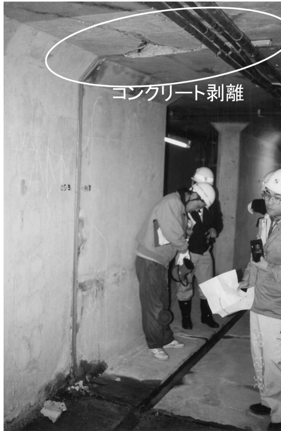
写真5 軸方向に受けた圧縮力によるジョイント部でのコンクリートの圧壊(1995年兵庫県南部地震)
