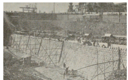
東京復興計画街路工事の進捗・九段坂改修工事「道路4(11)」道路協会1925年(国会図書館デジタルコレクション)
