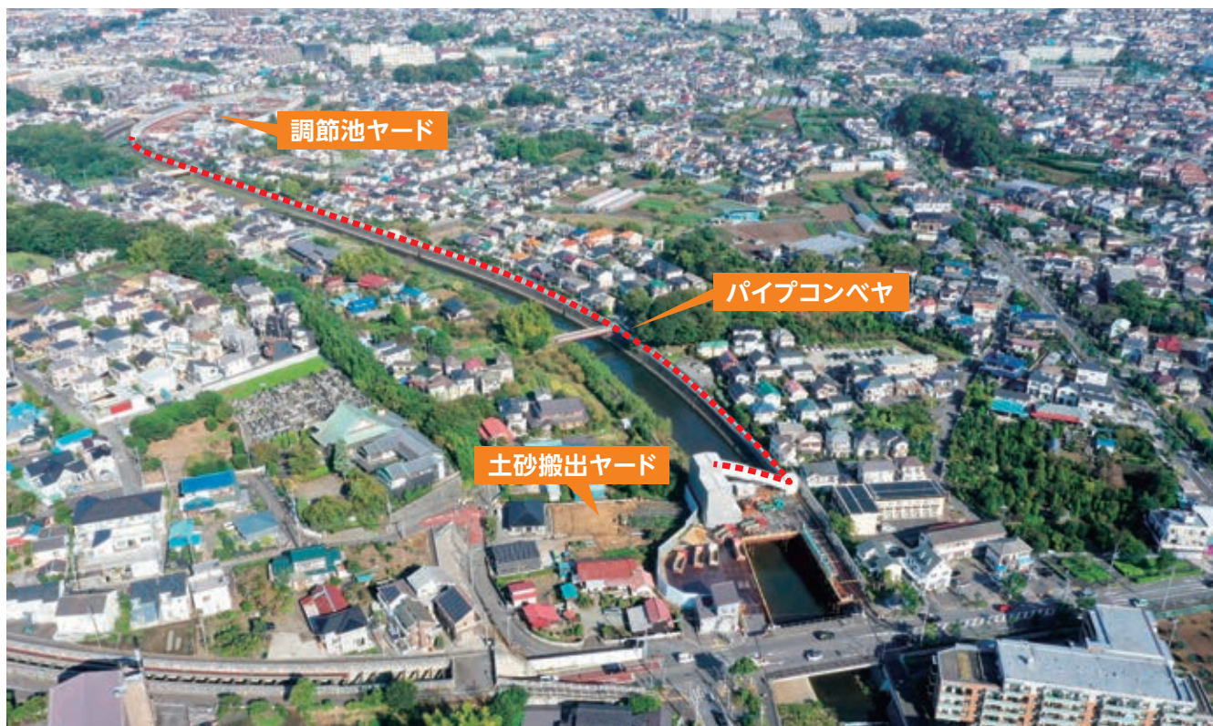
【図-8】パイプコンベヤの全景
