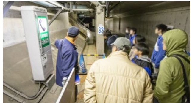
避難用滑り台と非常用電話。こうした設備は150～300mピッチで設置されており、非常用電話を使用すると、さいたま市にある道路管制センターに繋がる
